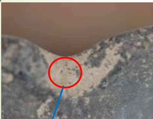
Acumulación de sedimentos
